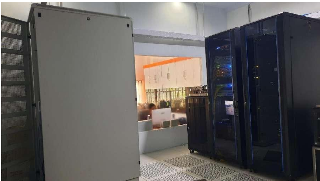
Gambar 2.5 Ruang Pusat Data Kabupaten Kulon Progo
